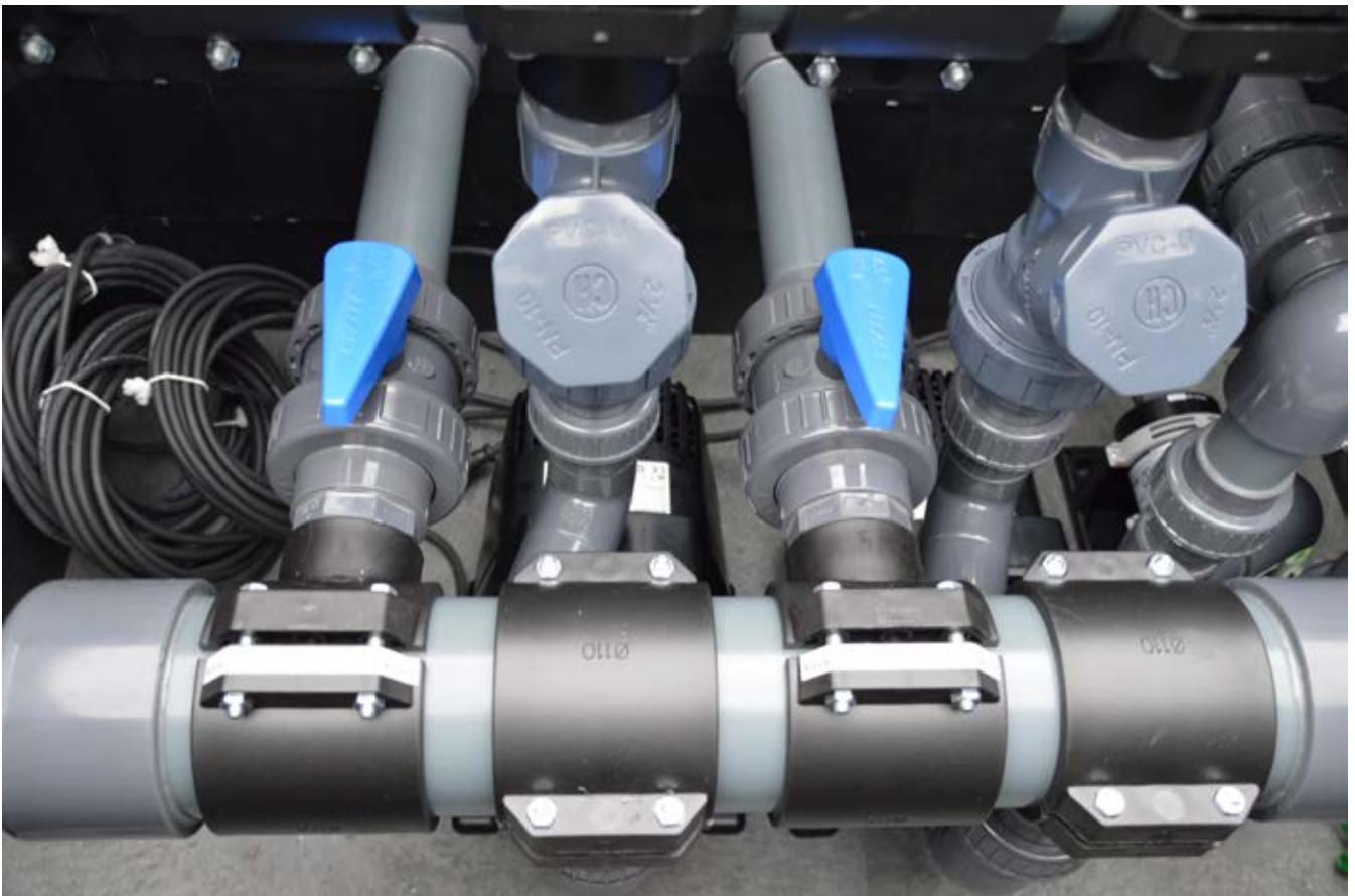
▲ Die Technik des Naturpools wird zum Frühjahr ins System zurückgebaut. Wichtig ist, dass die Technik gut gereinigt ist, um einen reibungslosen Betrieb zu garantieren.
