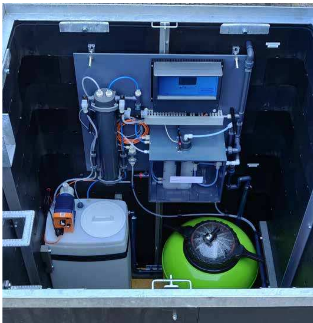
▲ Im Cubis, dem Technischacht der teichitekten, werden alle technischen Komponenten untergebracht.
