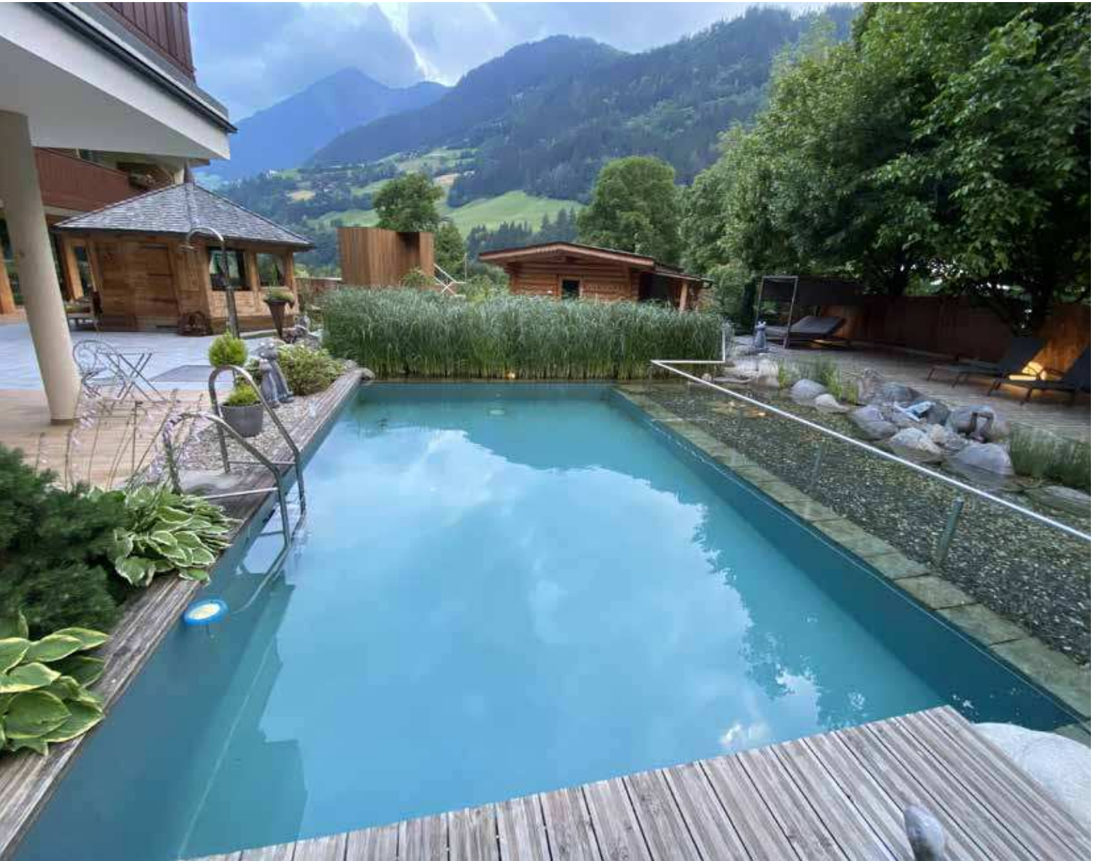
▲ Membranelektrolyseanlagen erreichen hervorragende Wasserqualitäten.
