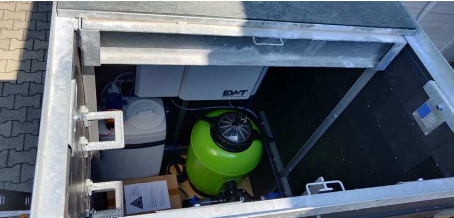
▲ Ein unscheinbarer weißer Kunststoffbehälter steht auf dem Boden des Technischachtes am Schwimmteich, darüber ist eine Elektrolyseanlage an die Wand gehängt.
