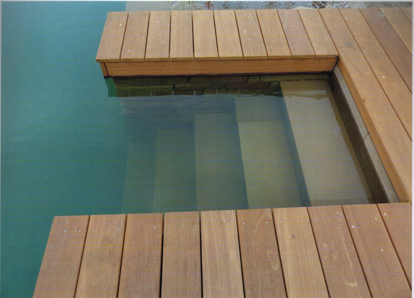
▲ Wege, Stege und Einstieghilfen werden leicht zu Gefahrenquellen. Darum ist ein Sicherheitscheck dieser Einbauten im Herbst wichtig.
