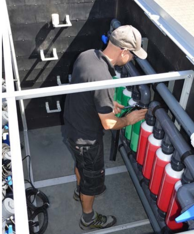
▲ Der Technikschaft hat die richtige Größe, wenn zu Wartungsarbeiten eine Person darin bequem stehen kann und genug Platz zum Austausch von technischen Teilen vorhanden ist.
