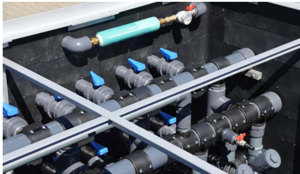
▲ Saug- und Druckanschlüsse, Nachfüllwasseranschlüsse, Rückschlagkappen, Probeentnahmehähne usw. Im Technikschacht ist die gesamte Technik des Schwimmteiches zentral untergebracht.
