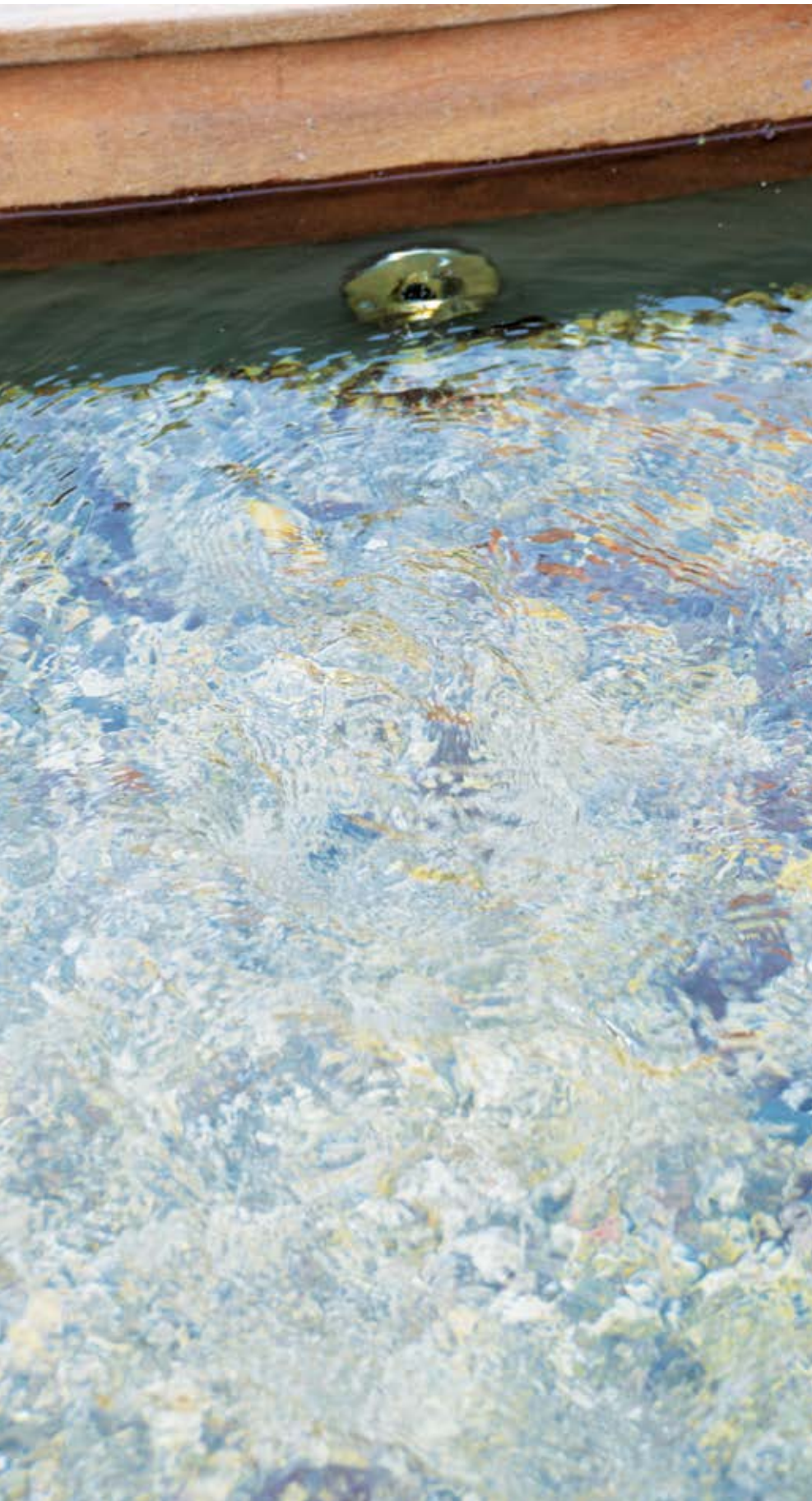
▲ Naturpools werden hydraulisch kontrolliert, z.B. mit Einströmdüsen.
