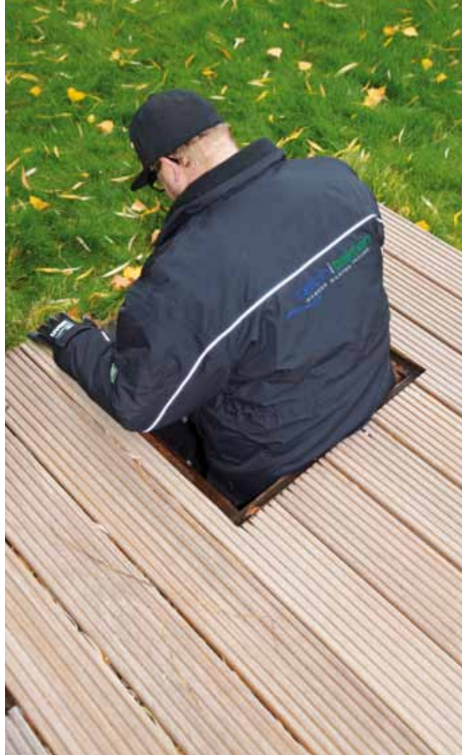
▲ Der Technischacht ist das Kontrollzentrum der Naturpool-Anlage. Hier beginnt der Winter-Technik-Check.
